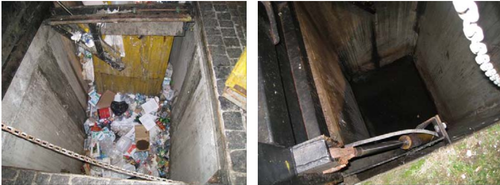
Interior de um poço de um contentor, tipo citytainer
