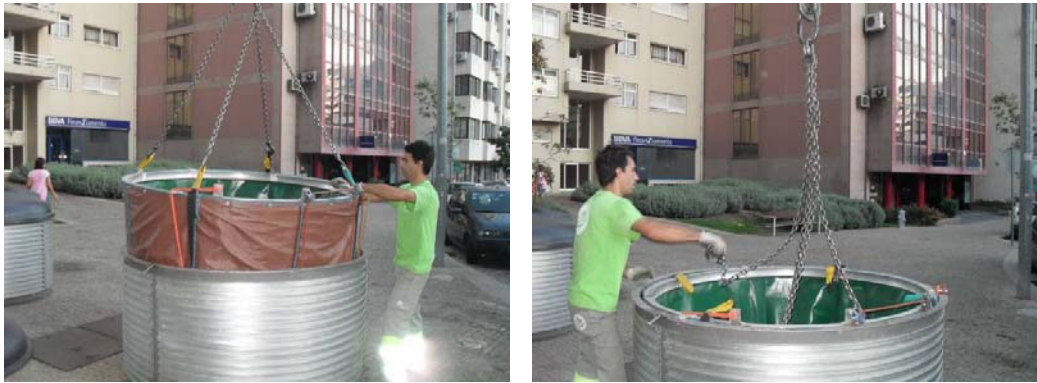
Entrada do saco de elevação no poço do molok.
