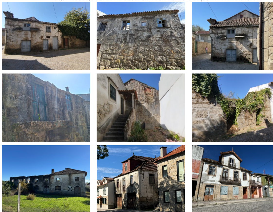
Figura 9. Exemplos de edifícios com estado crítico de conservação – Ruínas - na ARU de Oliveirinha
