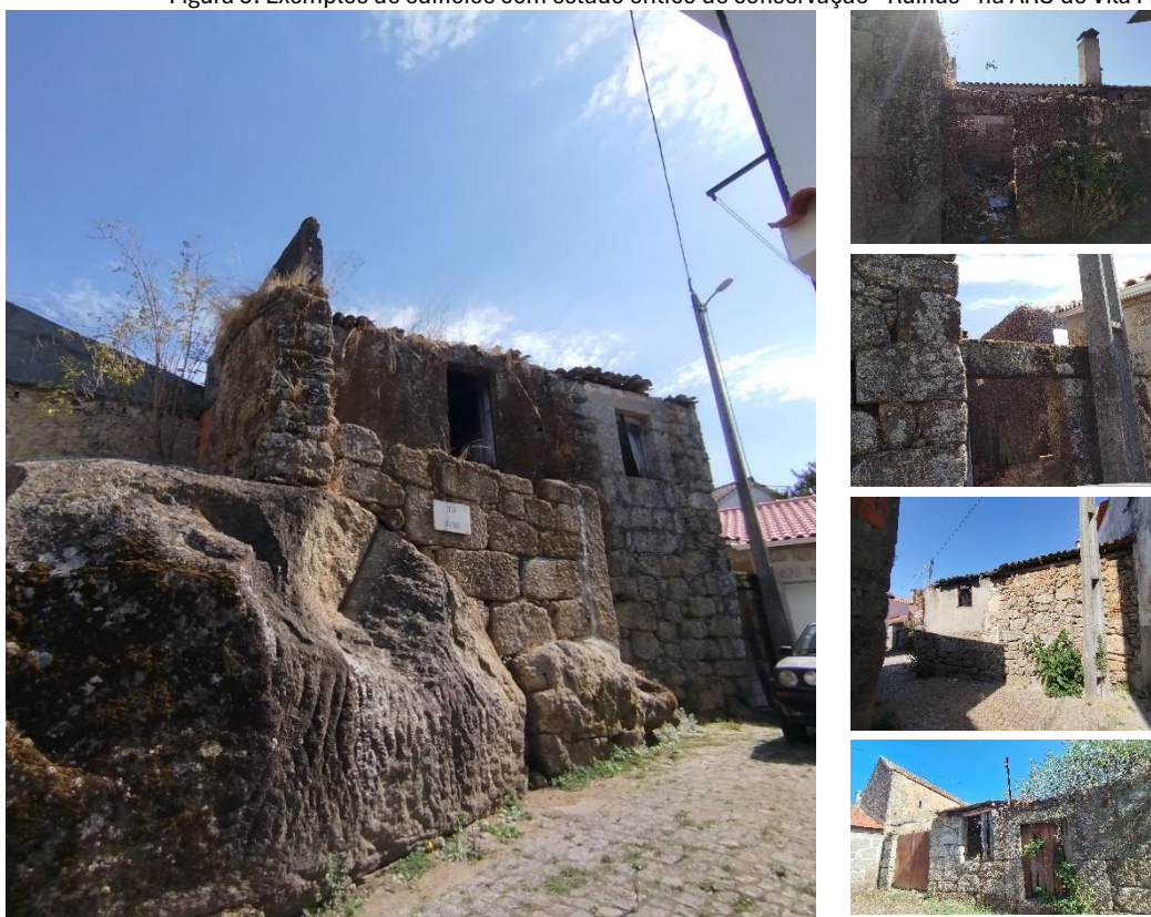
Figura 9. Exemplos de edifícios com estado crítico de conservação - Ruínas - na ARU de Vila Meã
