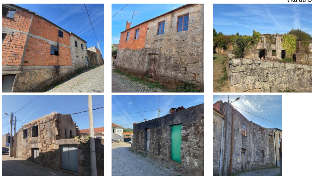
Figura 9. Exemplos de edifícios com estado crítico de conservação – Ruínas - na ARU de Casal da Torre, Casal Mendo e Vila da Cal
