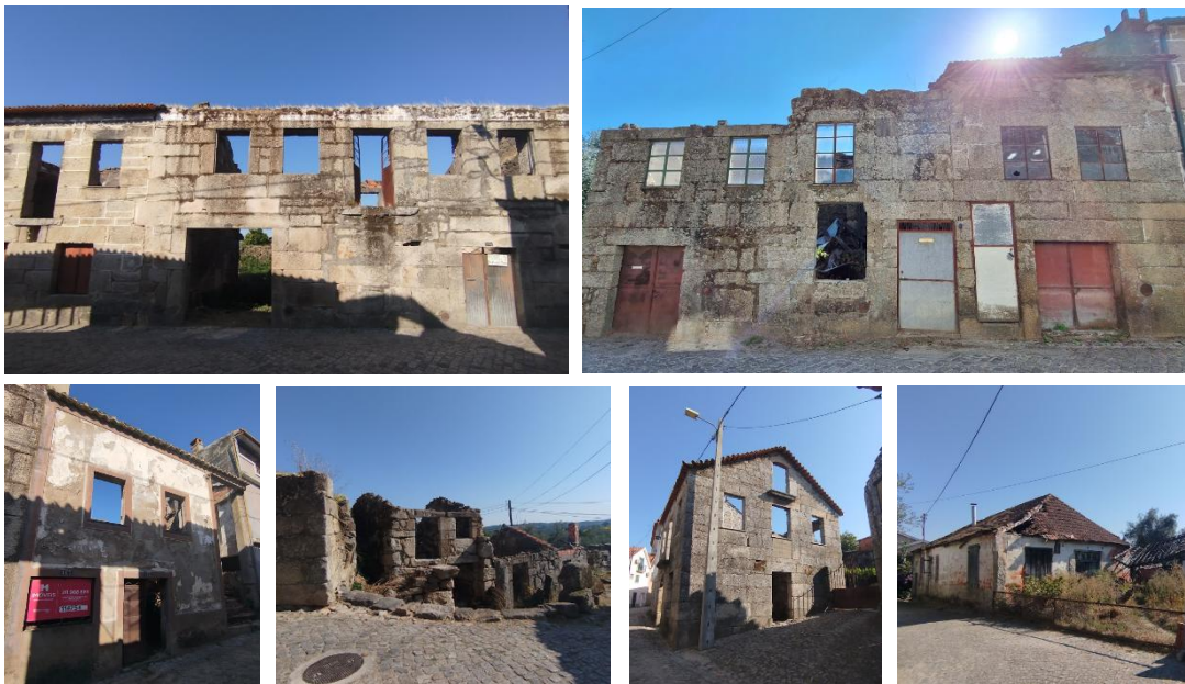
Figura 9. Exemplos de edifícios com estado crítico de conservação – Ruínas - na ARU de Pardieiros
