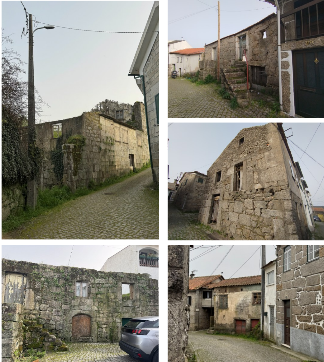
Figura 9. Exemplos de edifícios com estado crítico de conservação – ruínas - na ARU de Cabanas de Viriato
