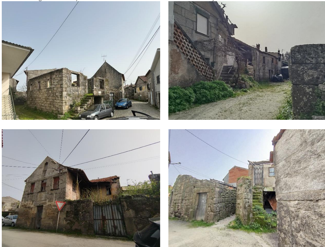
Figura 8. Exemplos de edifícios com estado crítico de conservação – ruínas - na ARU de Fiais da Telha
